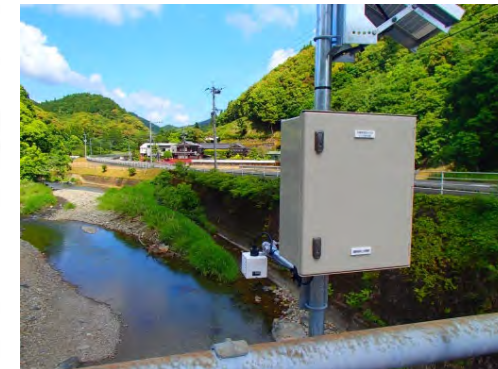
危機管理型水位計設置例： 小川梅木橋 (北浦町)
