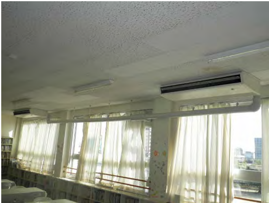
空調整備後の特別教室(岡富小学校)
